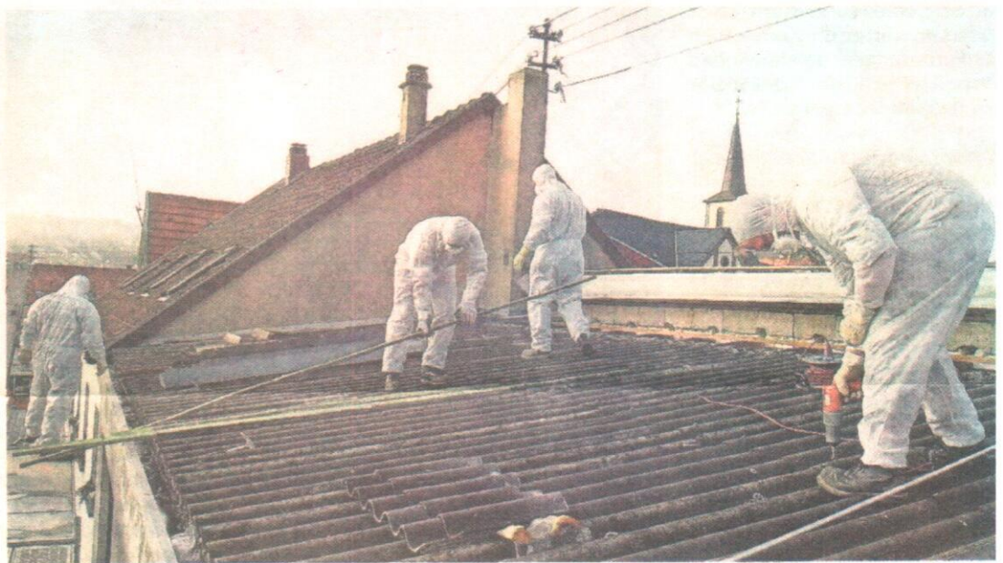
Arbeiter mit Schutzanzügen entsorgen in Eppelborn eine Eternit-Eindeckung. Die Arbeit ist gefährlich denn eingeatmete Asbestfasern können Krebs verursachen. FOTO: ENGEL
